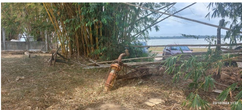
Figura 3 - Poço Artesiano inoperante no Campus sede da UFPA (P5)
