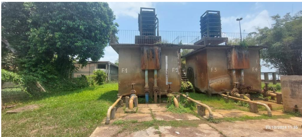
Figura 4 - Estação de Tratamento de Água da UFPA
