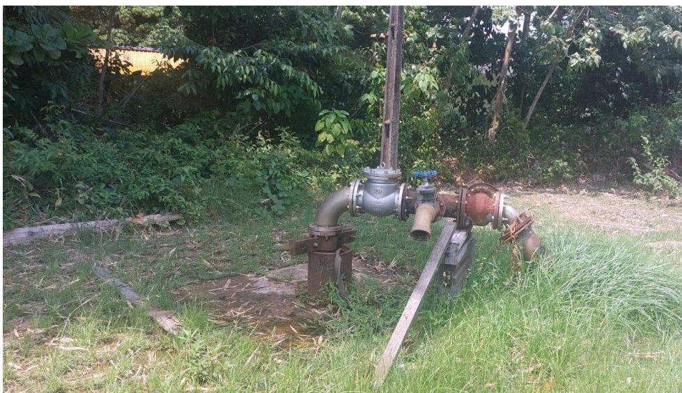
Figura 2 - Poço Artesiano em operação no Campus sede da UFPA (P6)
